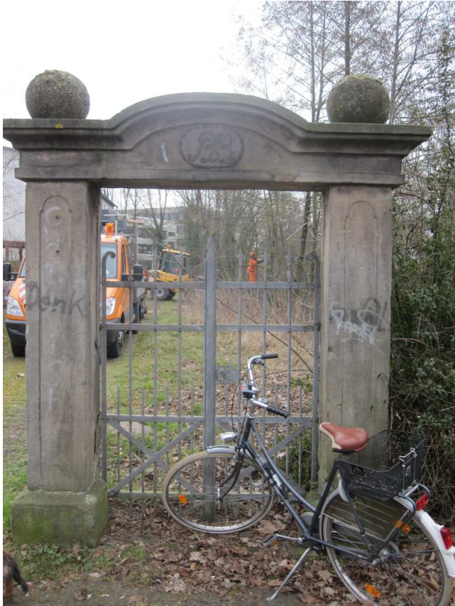
Fotos vom Zustand des Tors im Februar 2019
